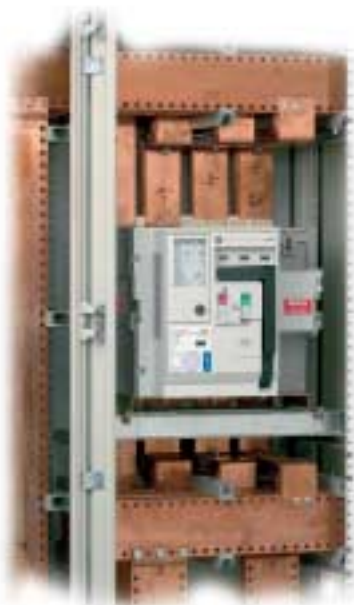
L'interruttore M-Pact installato in un armadio in metallo della serie Modula.
