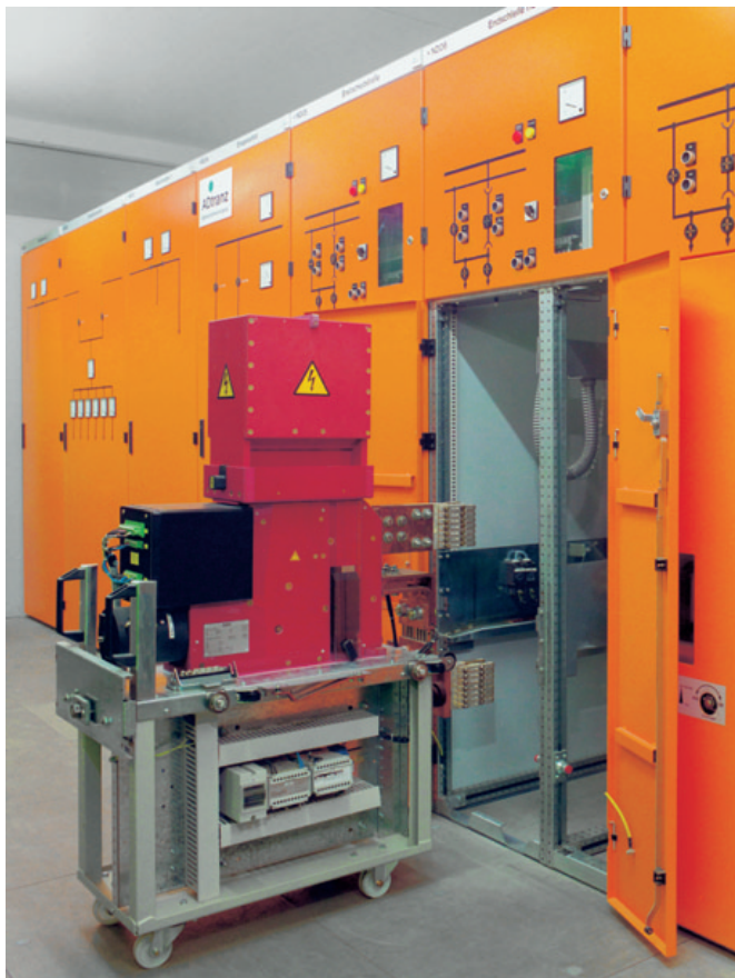
Gleichstromschaltanlage für Bahnstromversorgung mit Gerapid 2607 in Ausfahrtechnik
