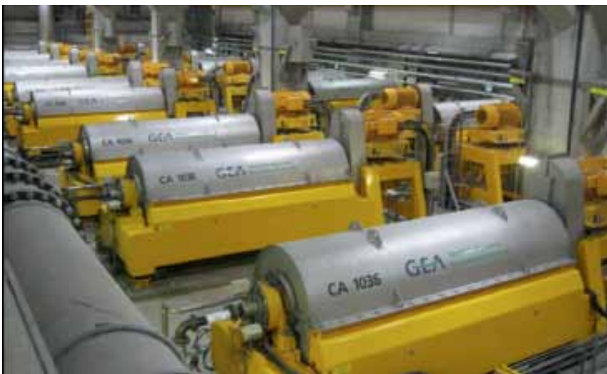
Sala centrifughe della Changi NEWwater
