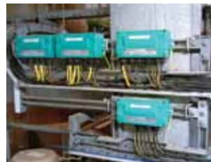
Installazione PROFIBUS, CoC Regno Unito
