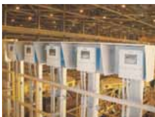
Installazione FOUNDATION Fieldbus CoC Cile
