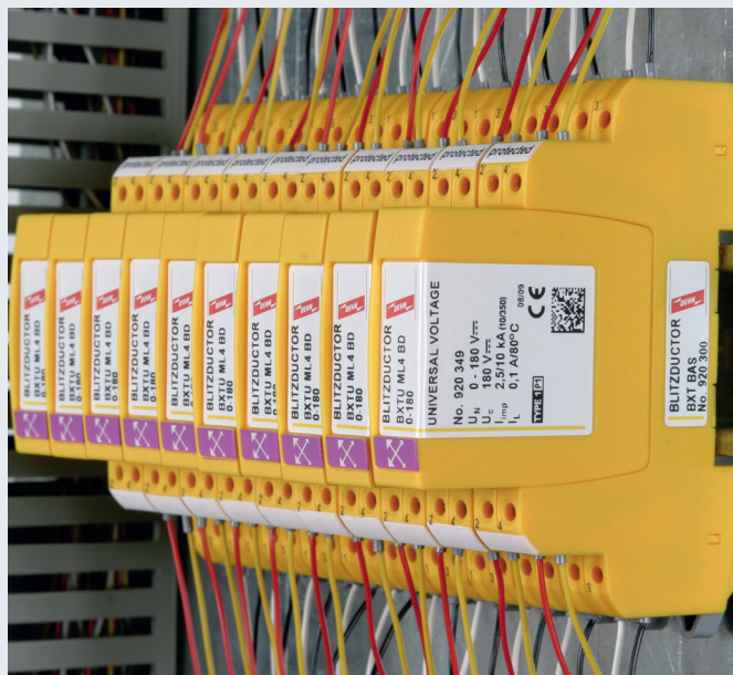
BLITZDUCTOR XTU nell'installazione.
