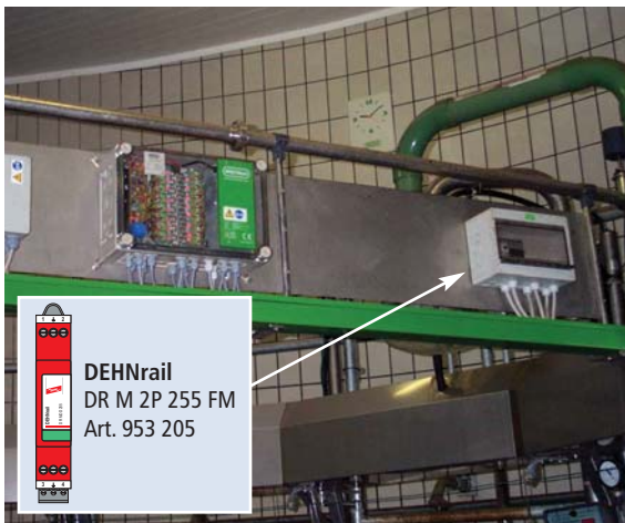
Figura 9.6.5 Quadri di comando per l'impianto di mungitura automatico
