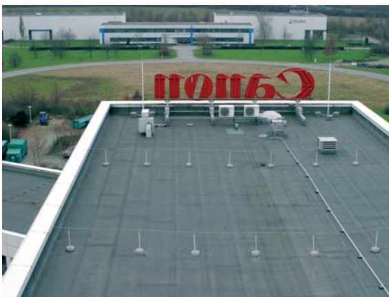
Figura 5.1.8.10 Impianto di captazione sospeso fonte: Blitzschutz Wettingfeld, Krefeld, Germania
