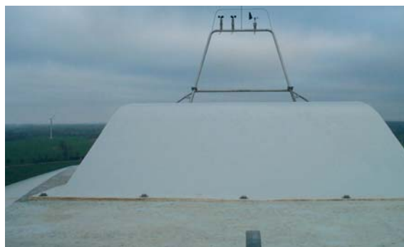
Figura 5.1.10.2 Protezione contro i fulmini per anemometro
