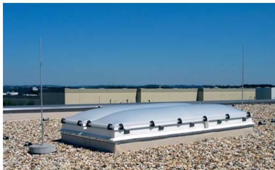
Figura 5.1.1.17 Protezione di piccole strutture sul tetto da fulminazione diretta con aste di captazione
