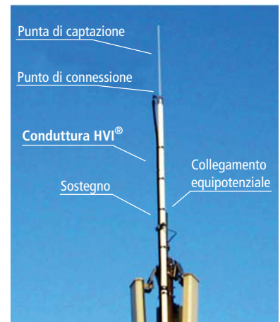
Figura 5.2.4.2.2b Tubo di sostegno nella zona dell'antenna
