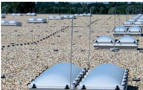
Figura 5.1.1.19 Tetto piano con aste di captazione e staffe portafilo: protezione per lucernari
