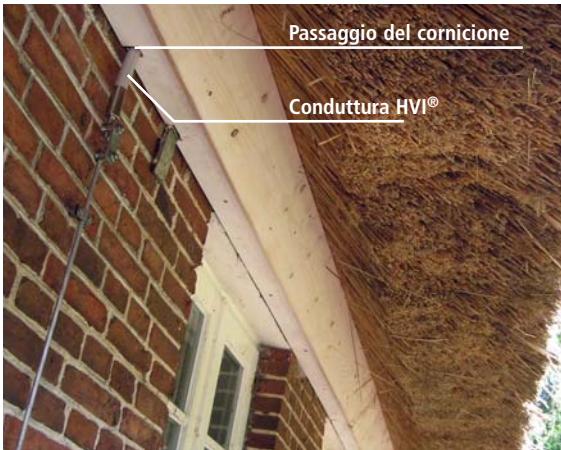
Figura 5.1.5.7 Conduittura HVI® attraverso il cornicione
