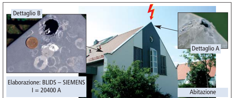
Figura 5.1.4.2 Esempio di danno su copertura in lamiera
