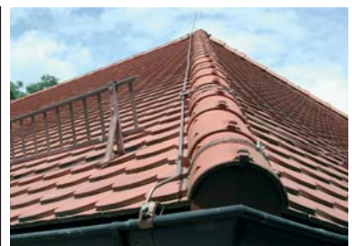
Figura 5.2.2.1.3 Organo di captazione con collegamento alla grondaia
