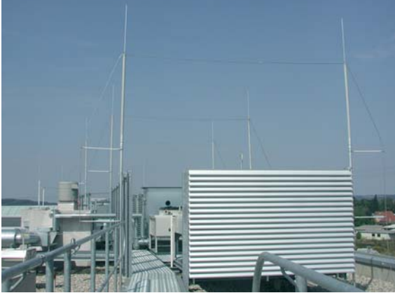
Figura 5.1.8.12 Impianto di captazione isolato con DEHNiso-Combi
