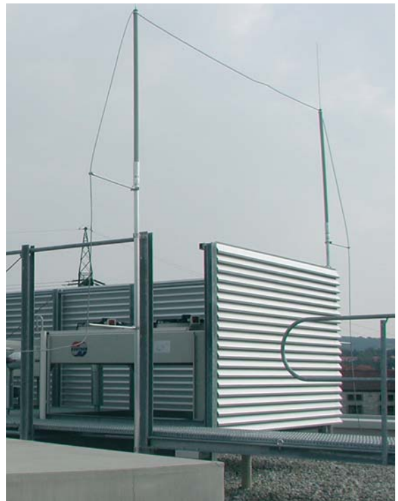
Figura 5.1.8.14 Impianto di captazione isolato con DEHNiso-Combi
